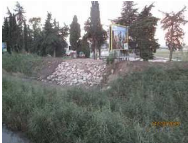
Doc DDTM : Travaux de rechargement d'urgence de la digue de la Frayère suite à leur rupture localisée
