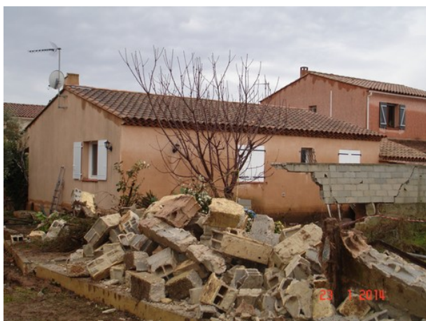
Illustration 3: Destruction généralisée de murs de clôture - La Londe-Les-Maures
