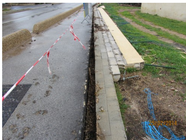
Illustration 2: Mur renversé, secteur Bormes-Les-Mimosas - Le Lavandou
