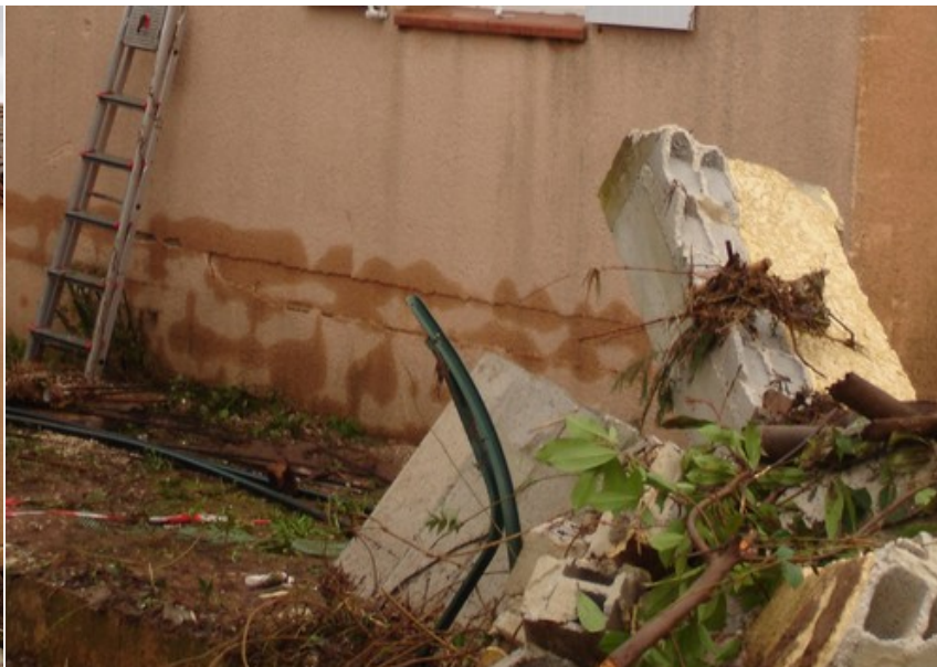
Illustration 6: Détail de la fissure
