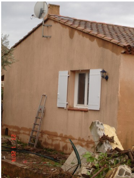
Illustration 7: Apparition d'une fissure périphérique au niveau de la dalle de plancher - La Londe-Les-Maures
