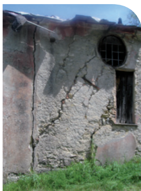
Ensemble de bâtiments fissurés, affectés par un affaissement lié à la dissolution de gypse, à Breil-sur-Roya (Alpes-Maritimes - 06) © Géolithe
