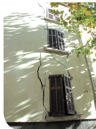
Fissures dans un bâtiment en centre-ville de Bargemon, liés à la dissolution du gypse en profondeur (Var - 83) © BRGM
