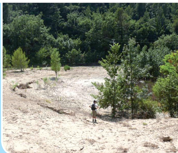
Affaissement des remblais déversés dans l'effondrement de La Clappe à Draguignan en juillet 2010 (Var – 83) © CEREMA
