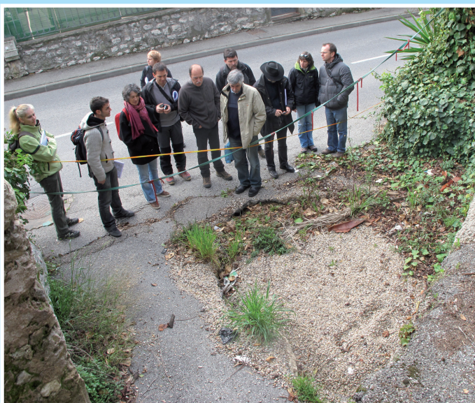
Effondrement survenu en 2013 sur Grasse (Alpes-Maritimes - 06) © BRGM
