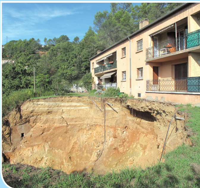
Vue de l'effondrement du Luc-en-Provence et du sous-cavage sous le bâtiment, en date du 17 octobre 2014 (Var - 83) © BRGM
