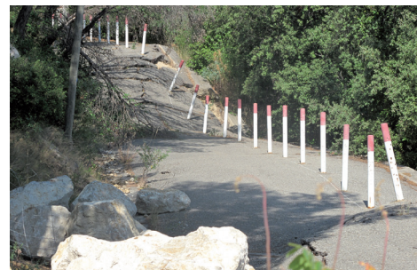
Grandes déformations de la route à l'aplomb d'une carrière de gypse ayant très probablement subi un effondrement généralisé à Aubagne (Bouches-du-Rhône – 13)
