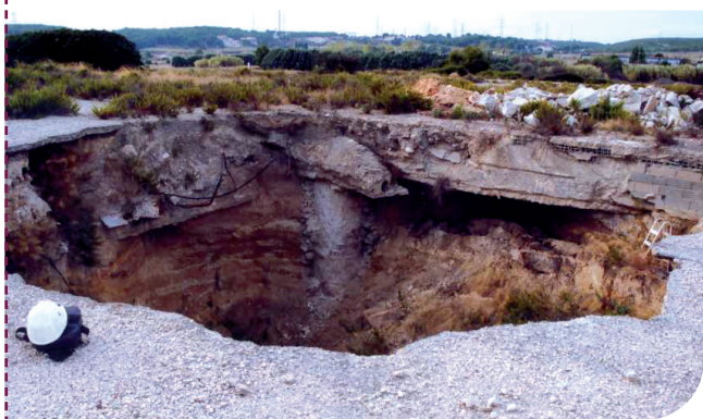
Fontis sur le site des anciennes carrières de gypse de Saint-Pierre-les-Martigues (Bouches-du-Rhône - 13) © BRGM
