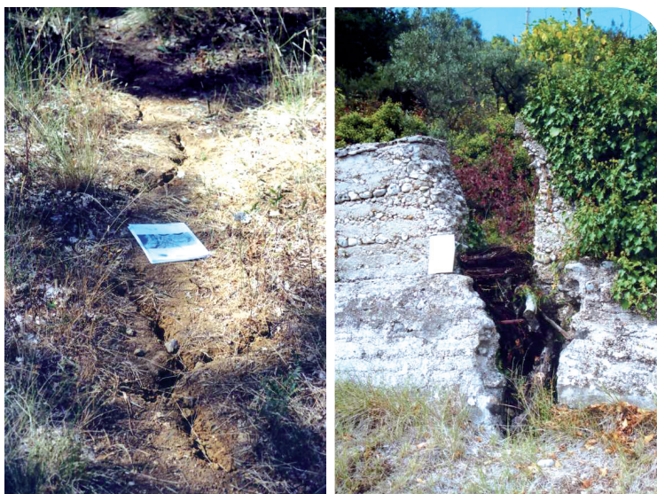
Indices d'effondrements avec fissuration du sol à Méounes (Var), et rupture d'un mur à Draguignan (Var - 83) © BRGM
