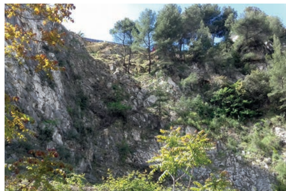
Falaise avant confortement
